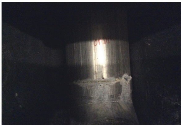
Lekkage door corrosie
